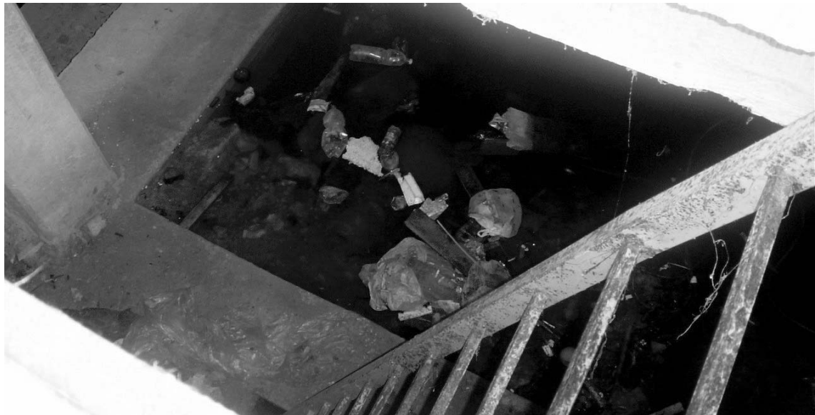
Il seminterrato in cui finisce l'acqua della fogna
