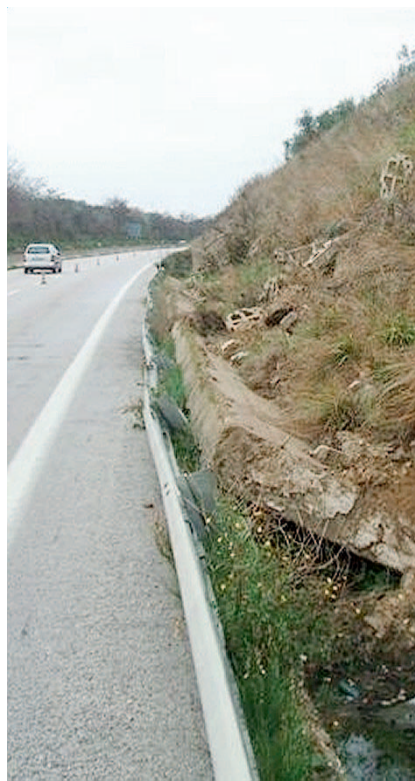
MURO PROVVIDENZIALE Il muro piegato dallo smottamento
