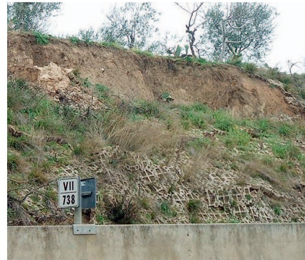
COSTONE FRANATO Le infiltrazioni hanno fatto cedere anche le opere di contenimento artificiale
